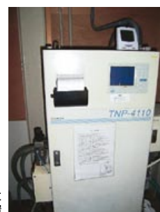
アイカ電子(株)に設置した全窒素・全リン測定装置
