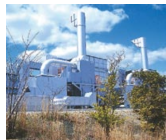
蓄熱式排ガス浄化装置
